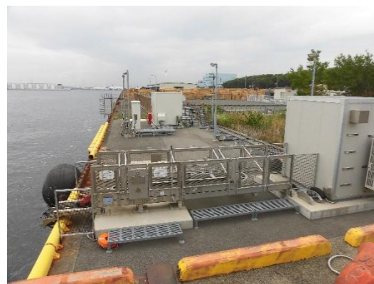
水素・電気補充設備
