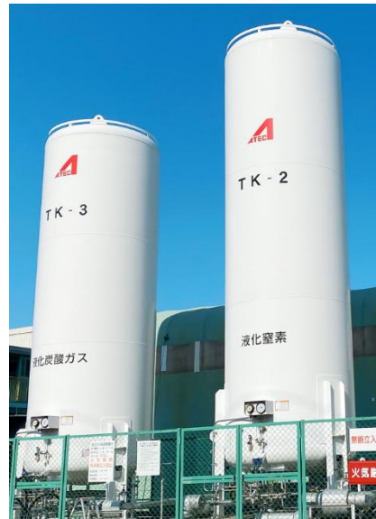
超低温液化ガス貯槽
